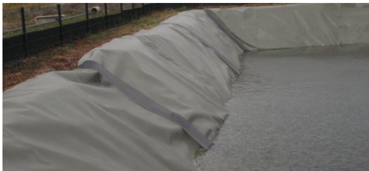
Figure 17 : Géomembrane permettant la sortie des amphibiens
